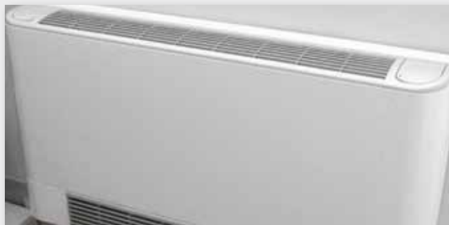
Anschluss an Konvektoren bei gewünschter Temperierung im Sommer.
